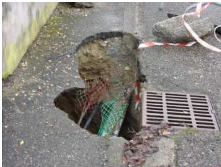
Rottura del manto stradale
